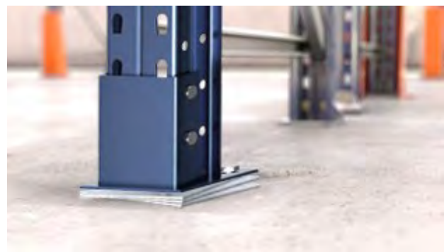
Placas de nivelación incorrectamente posicionadas
