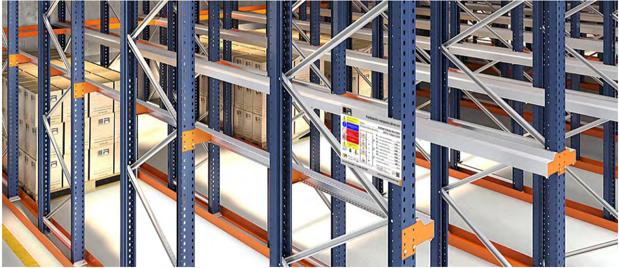
Placa normalizada de características correctamente situada
