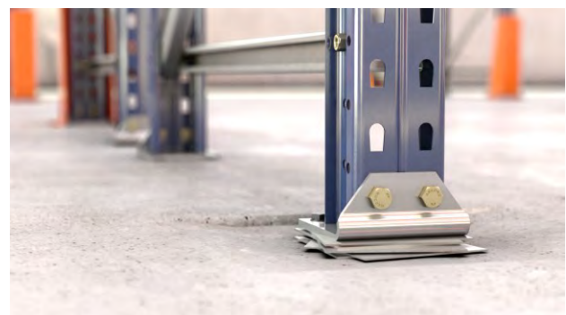
Placas de nivelación incorrectamente posicionadas
