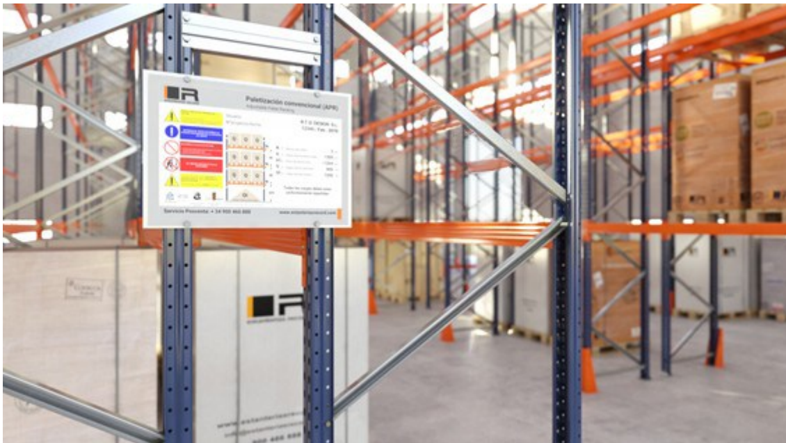
Plaque signalétique normalisée correctement située
