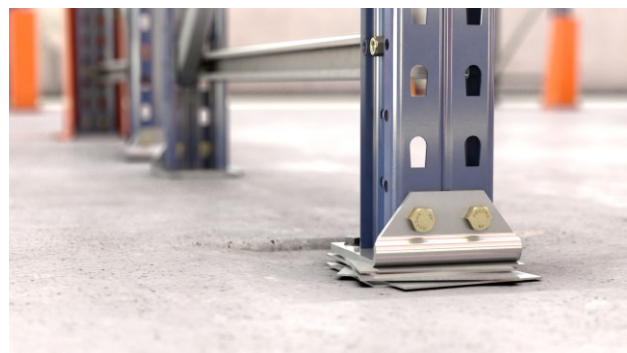
Plaques de nivellement incorrectement positionnées
